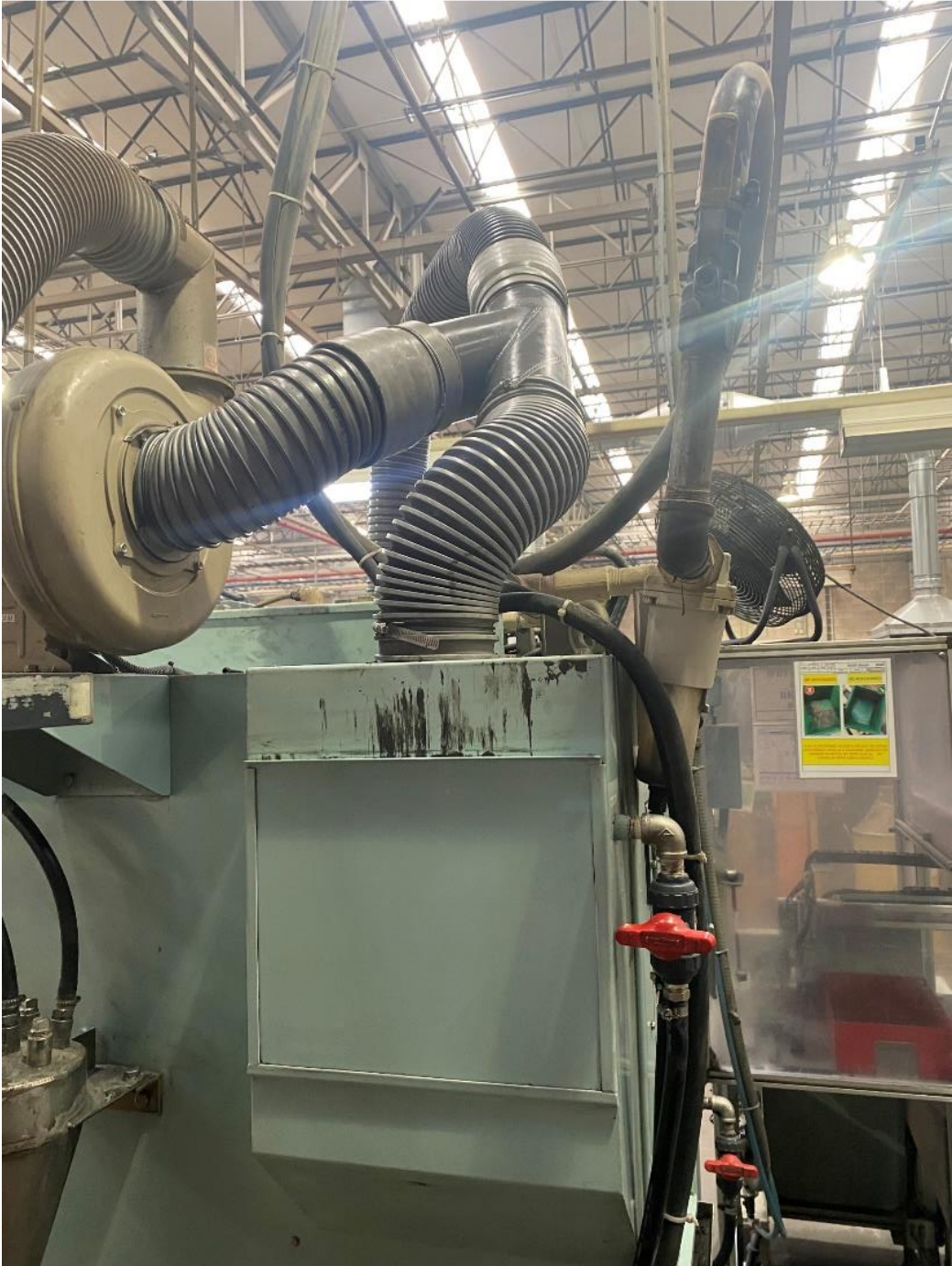
Ilustración 37. Conexión hacia sistema de extracción.
