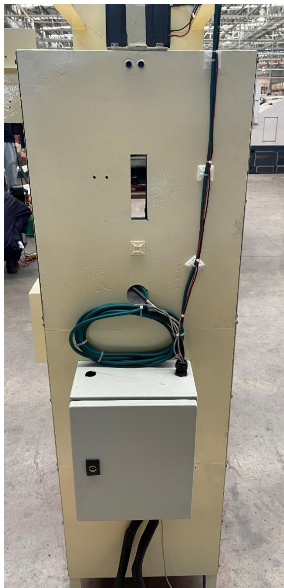
Ilustración 27. Parte trasera de Poka Yoke, ubicación de tablero de control.
